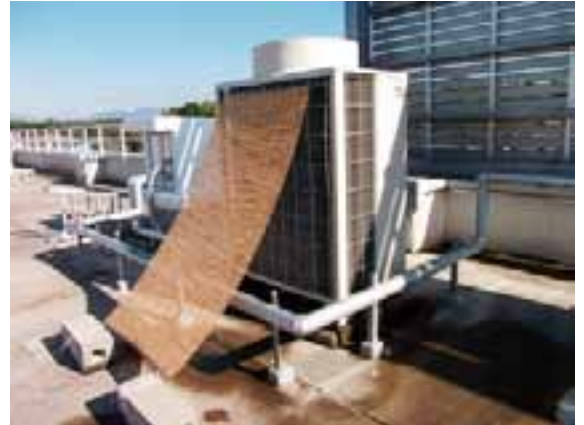
エアコン室外機のすだれ
